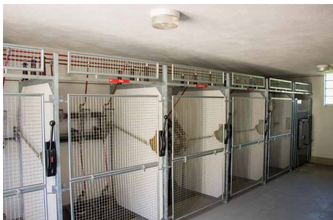
Transformatoren-Station Moosweg vorher
