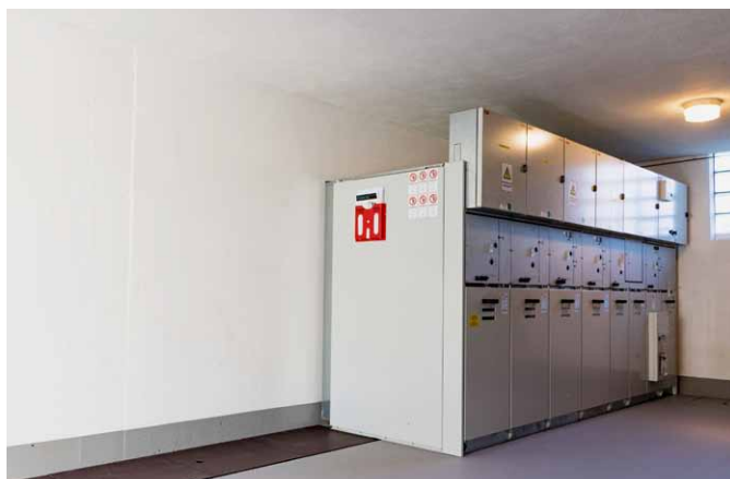
Transformatoren-Station Moosweg nachher
